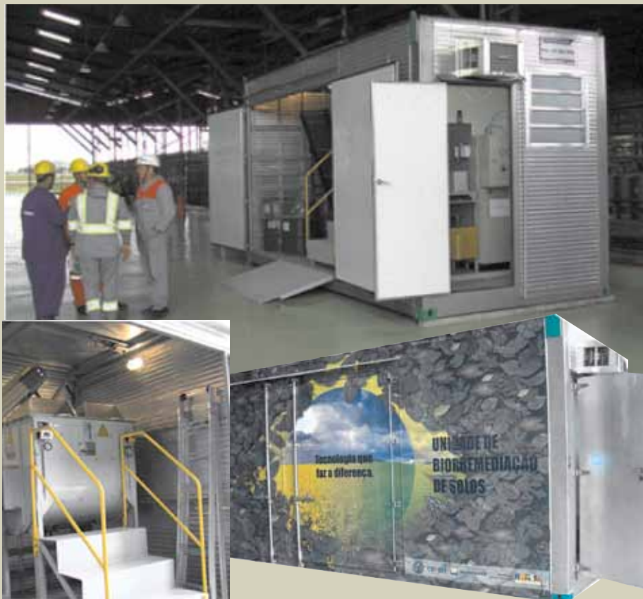
Fig. 7: Unidade de biorremediação de solos desenvolvida por pesquisadores do CETEM, PETROBRAS e Escola de Química da UFRJ, instalada na UN-REDUC (RJ).
