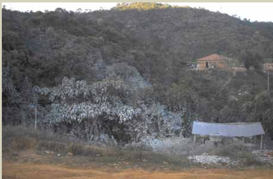
Fig. 12: Construção das Instalações da Unidade de Referência em Tecnologias Sociais para a arte de pedra-sabão na comunidade de Mata dos Palmitos em Ouro Preto (MG).
