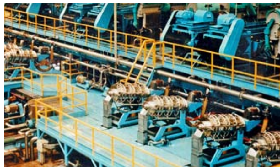
Bateria de turbofiltros em indústria de suco de laranja: redução de consumo e de risco de contaminação
