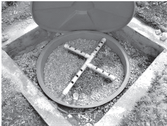
Figura 4.30 Filtro de brita para o tratamento da água cinza.
