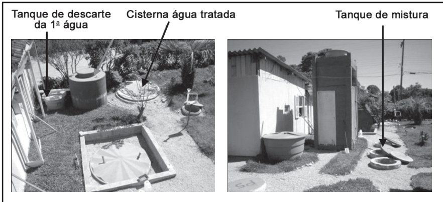
Figura 3.30 Fotos das unidades de tratamento e armazenamento de água de chuva.
