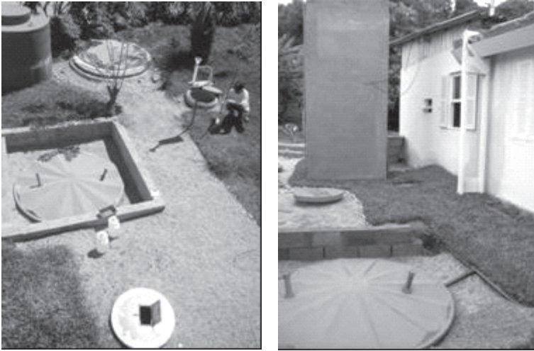
Figura 5.13 Vista do Sistema instalado na UFSC.
