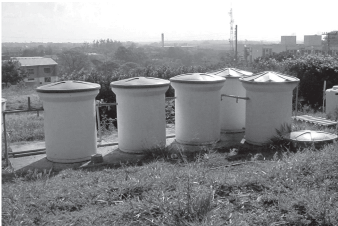
Figura 5.16 Vista do RAC instalado na UNICAMP
