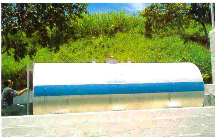
Figura 77: Tanque de combustível da Engemix
