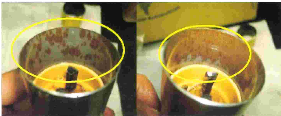
Figura 52: Oxidação na casca externa da bomba de combustível
