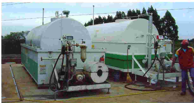
Figura 93: Infraestrutura de abastecimento de óleo diesel (B2/B3) e misturas B5 da Rodomax
