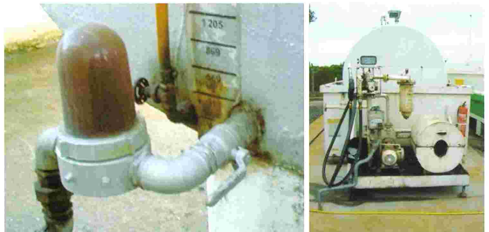
Figura 138: Sistemas de filtragens com baixa eficiência
