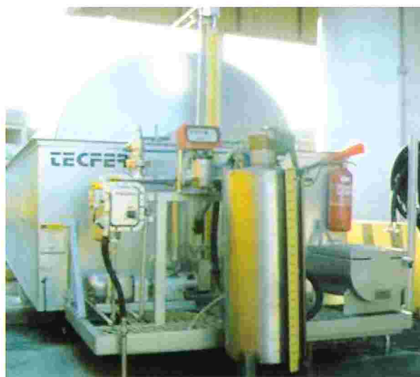
Figura 68: Tanque de armazenagem e sistema de abastecimento da Real Auto-Ônibus
